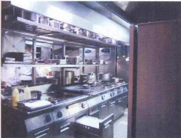
Vybavení restaurační kuchyně
