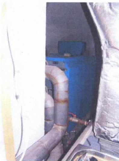
Plynová kotelna v podkroví na ohřev TUV
