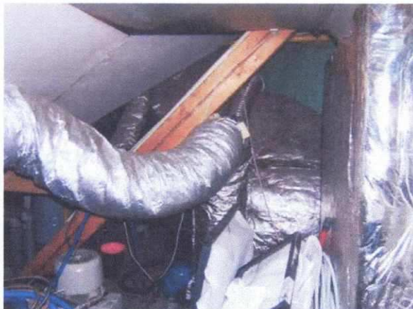
Strojovna vzduchotechniky v podkroví
